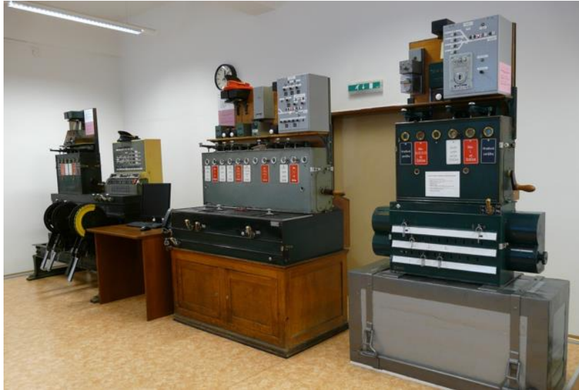
Obr. 4 Elektromechanické zabezpečovací zařízení
