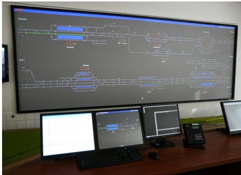
Obr. 5 Jednotné obslužné pracoviště (JOP) elektronického zabezpečovacího zařízení
