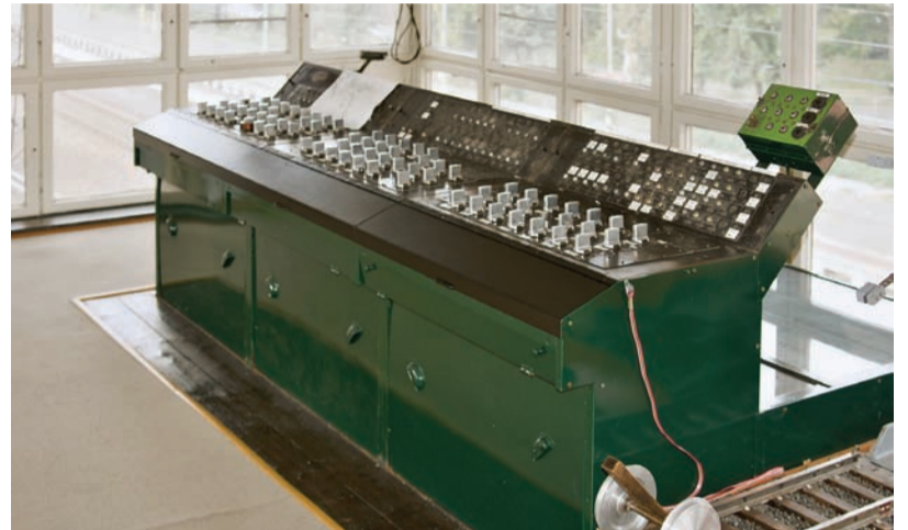
Hlavním lákadlem expozice je elektrodynamické zabezpečovací zařízení z roku 1942.
