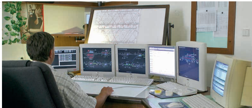
Zabezpečovací zařízení ESA 11 v Českých Budějovicích
