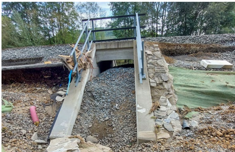
Stav poškození po povodni...
