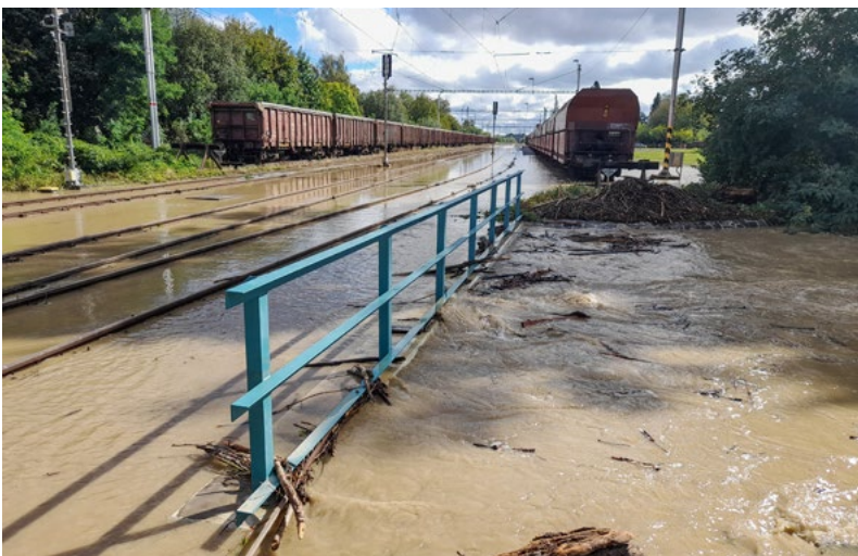
Stav poškození po povodni...
