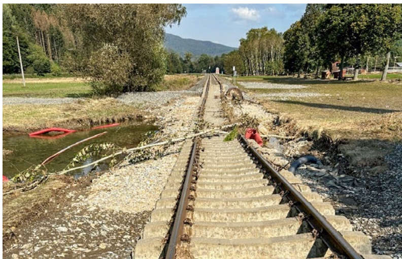
Stav poškození po povodni...
