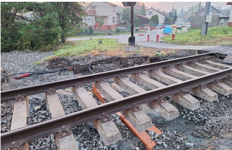
Stav poškození po povodni...
