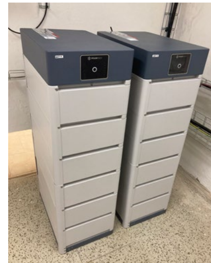
Bateriové úložiště jako součást FVE na objektu Ostrava-Muglinovská
