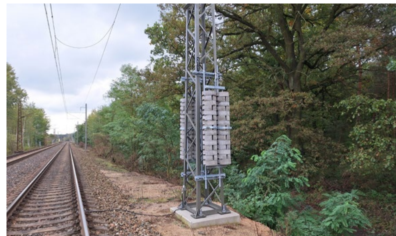
...a po obnově
