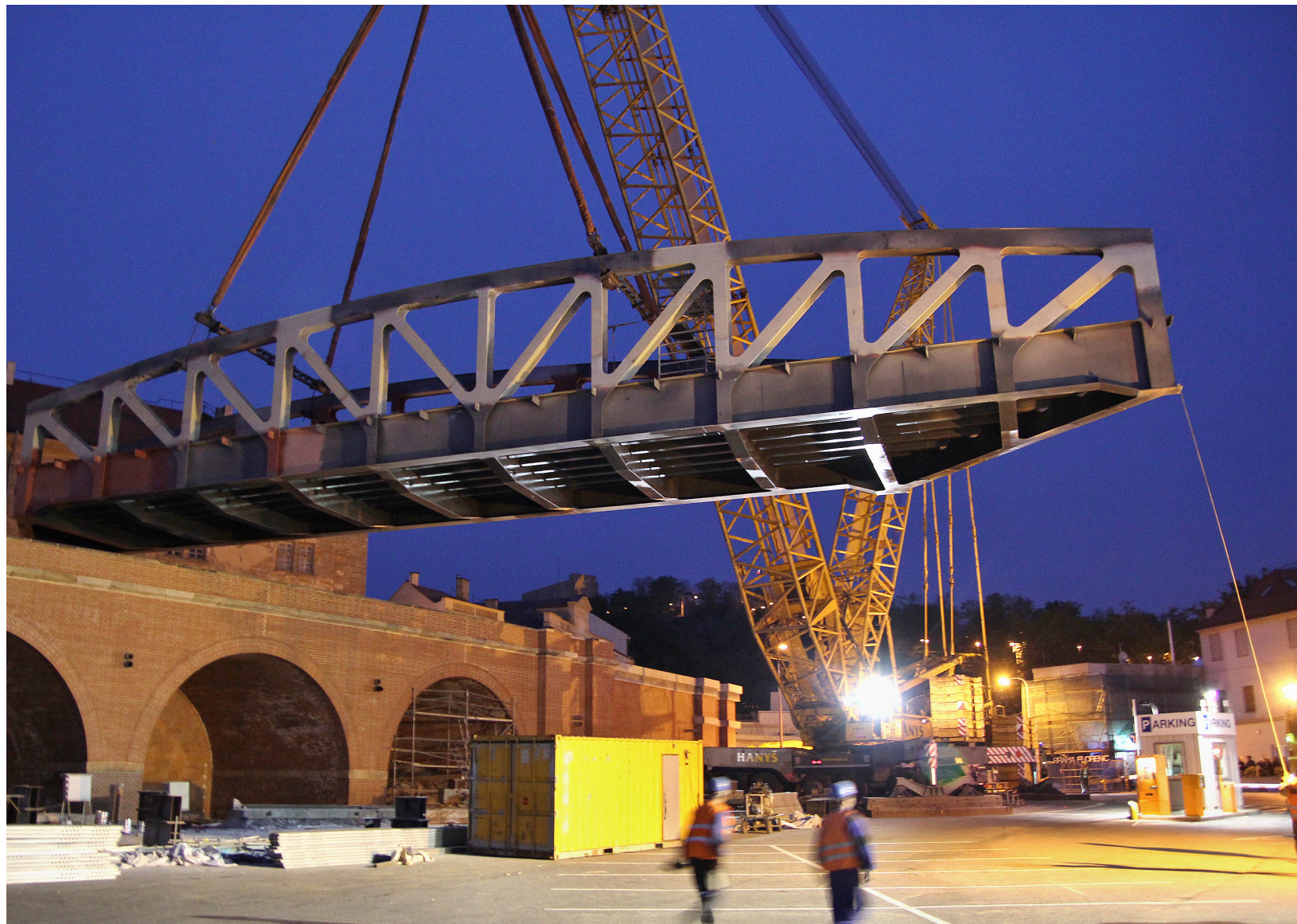
Osazování 169 tun vážící mostní konstrukce přes ulici Prvního pluku, které proběhlo 8. května 2019
