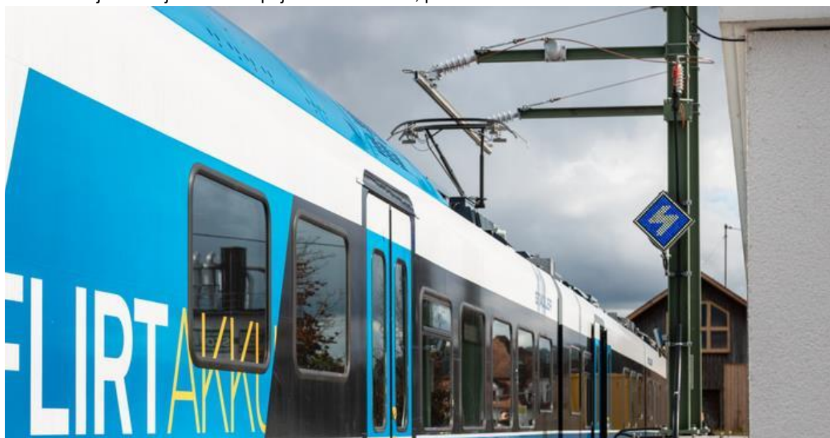
Obr. 6 Nabíjecí stanice společnosti Voltap pro nabíjení bateriových vlaků ve stanici [5]
