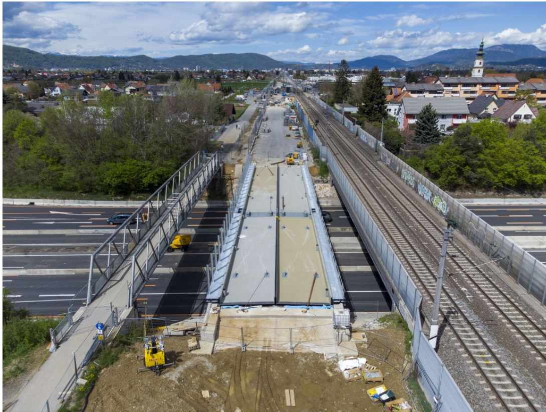
Foto 2: Výstavba nového dvoukolejného mostu Koralmské dráhy v obci Feldkirchen přes dálnici A2, vedle něj stávající most Jižní dráhy (rok 2020)
