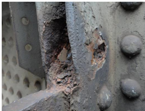
TYPICKÁ KOROZE SVISLICE V MÍSTĚ STYČNÍKU S DOLNÍK PÁSEM
