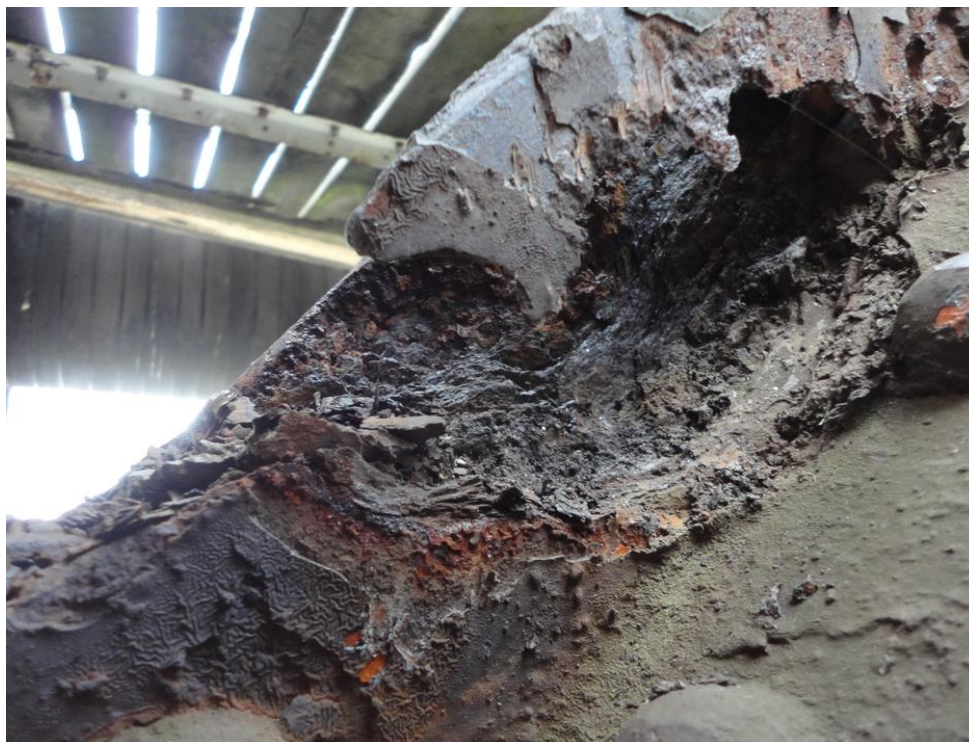
Koroze v přípoji diagonály ( NK1 vpravo - D.7) ke styčnickovému plechu dolního pásu U.7
