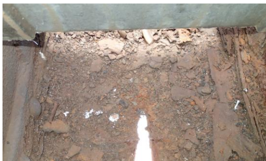
TYPICKÁ KOROZE DOLNÍHO PÁSU V MÍSTĚ STYČNÍKU (DIAGONÁLA/SVISLICE)
