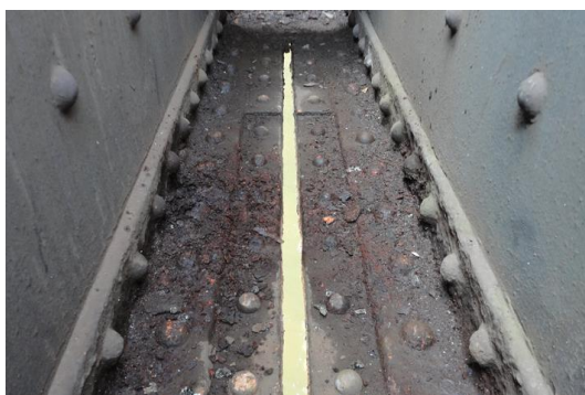
TYPICKÁ KOROZE DOLNÍHO PÁSU V USEKU MEZI STYČNÍKY
