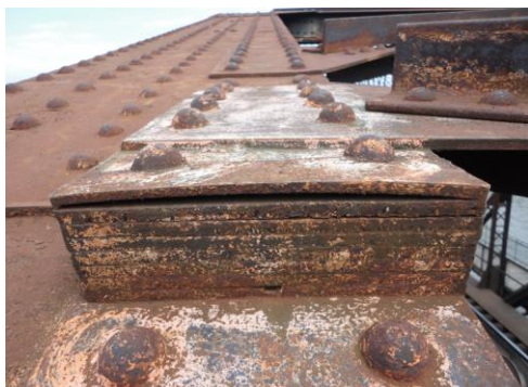
-DEFORMACE STYČNÍKOVÉHO PLECHU PŘIPOJENÍ ZTUŽENÍ
