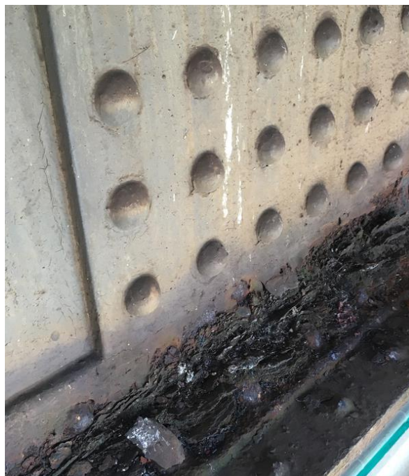
Koroze krčných úhelníků dolních pásů v místech se stálou vlhkostí
