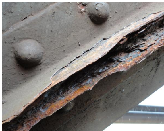
TYPICKÁ ŠTĚRBINOVÁ KOROZE DIAGONÁLY
