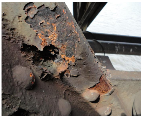
TYPICKÁ KOROZE DIAGONÁLY V MÍSTĚ STYČNÍKU S DOLNÍK PÁSEM
