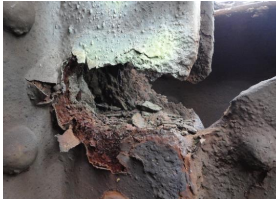
TYPICKÁ ŠTĚRBINOVÁ KOROZE SVISLICE
