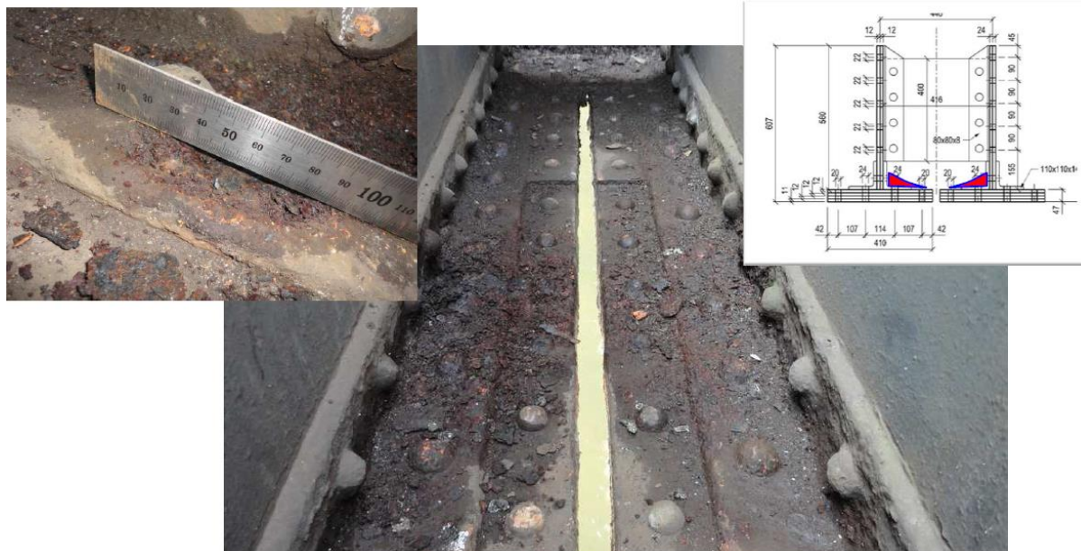
Typická koroze dolní pásů hlavního nosníku
