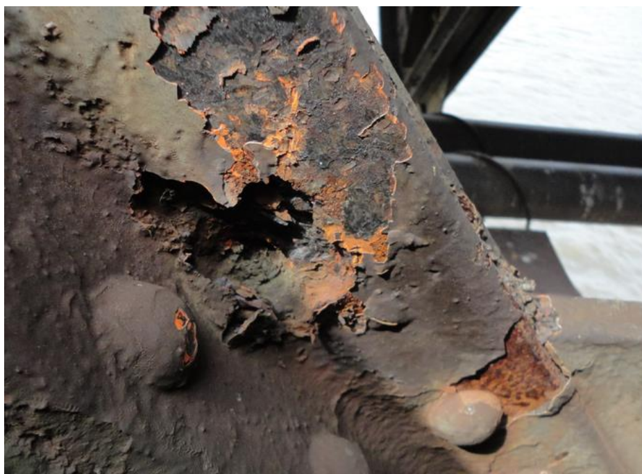
Koroze v přípoji diagonály (NK2 - vpravo D.7) ke styčnickovému plechu dolního pásu U.7
