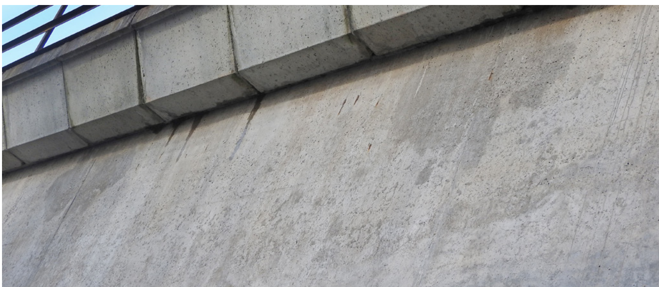
Obr. 4.21 – Železniční most přes řeku Ploučnici u Zákup – nepravidelná síť (tmavších) trhlin na boční ploše nosníku od nelineárních účinků teploty („nerovnoměrného oslunění“); most v km 90,270 na TÚ 1141 Česká Lípa – Liberec
