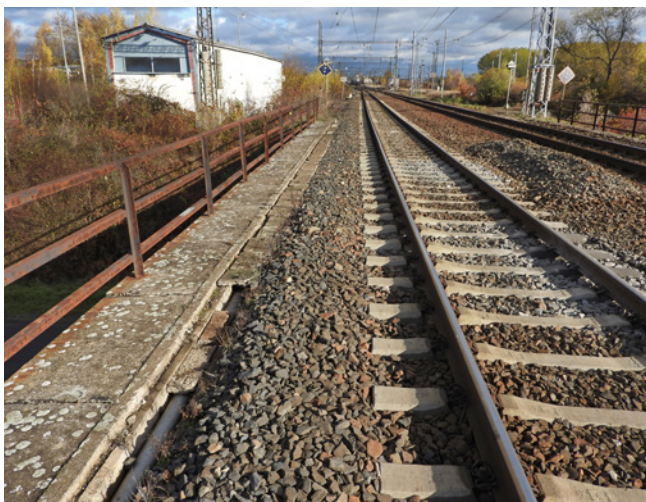
Obr. 4.42 – Železniční most přes potok Hačka u Spořic – přetížení mostu navýšeným kolejovým ložem; most v km 126,272 na TÚ 0112 Chomutov–Cheb
