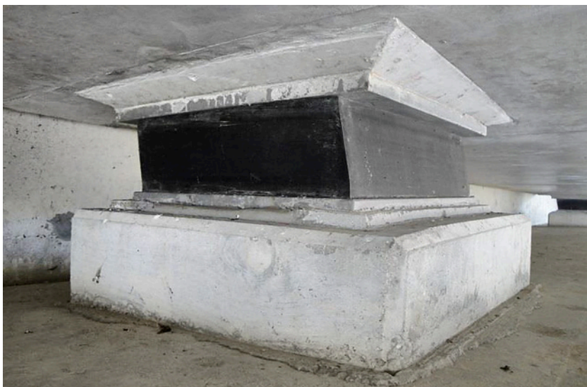
Obr. 2.34 – Elastomerové ložisko zkosené vlivem vodorovného posunu nosné konstrukce
