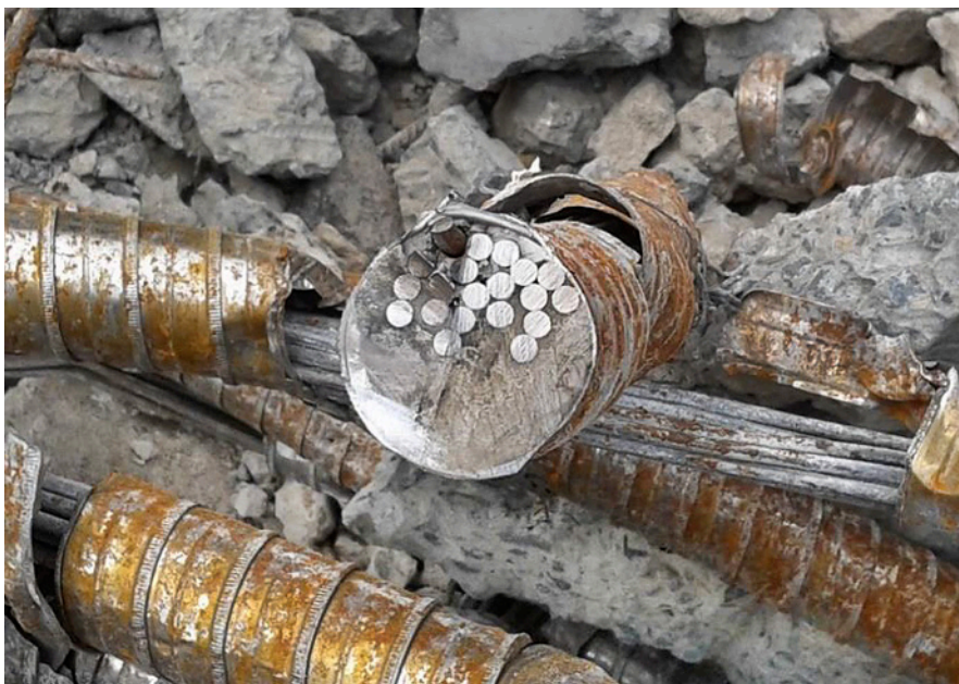
Obr. 2.16 – Kabel z 20 \varnothing P4,5 vyjmutý ze zrušené konstrukce (kabelový kanálek, patentované dráty, injektážní malta); viditelná koroze kovové hadice kabelového kanálku je zřejmě do značné míry způsobena tím, že kabel byl po vyjmutí z konstrukce asi 2 týdny vystaven vnějšímu prostředí.
