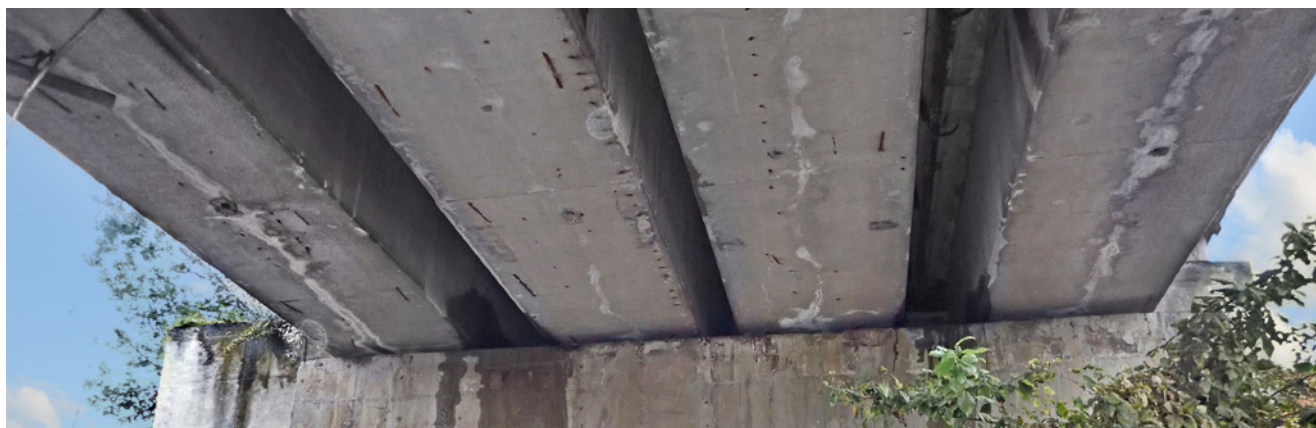
Obr. 3.76 – Typické poruchy nosníků PSKT: koroze výztuže, výluhy
