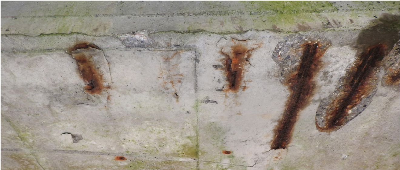
Obr. 4.30 – Železniční most u Hluboček – odtržení krycí vrstvy výztuže v důsledku zvětšování objemu korozních produktů, výrazně zkorodovaná betonářská výztuž; most v km 12,897 na TÚ 2191 Olomouc–Krnov
