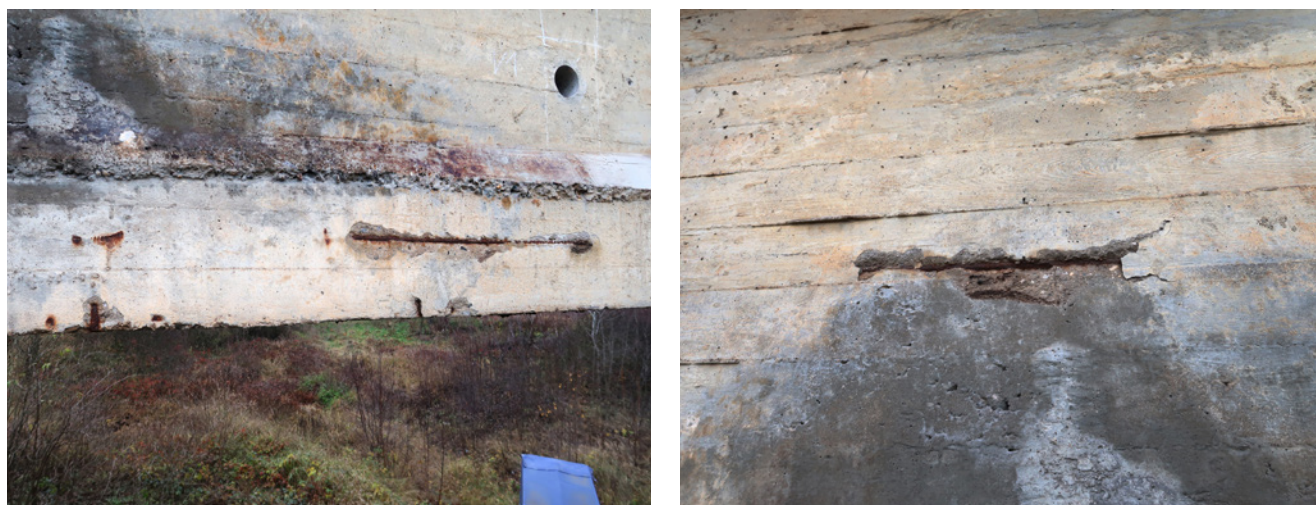
Obr. 3.130 – Vlevo: odstraněná degradovaná vrstva betonu, po odstranění degradované vrstvy betonu patrná silná koroze měkké výztuže; vpravo: silná koroze měkké výztuže levého trámu u opěry OP1, která má minimální krytí
