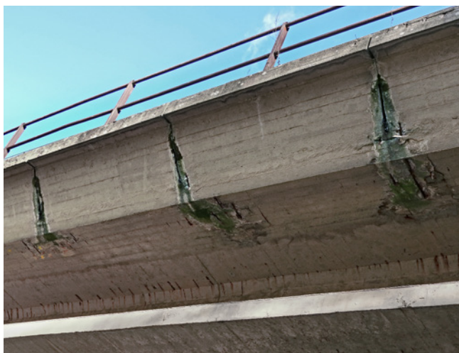
Obr. 4.16 – Železniční most přes řeku Bílinu u Lysce – zatékání příčnými dilatačními spárami monolitických konzol; most v km 15,642 na TÚ 0661 Ústí nad Labem – Bílina
