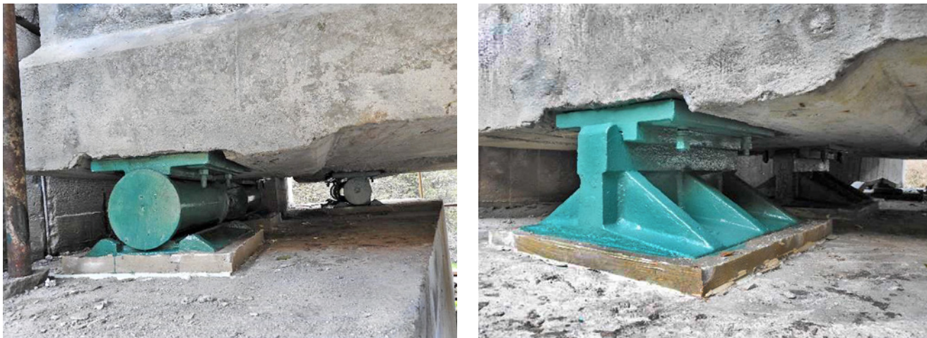
Obr. 2.33 – Železniční most u Pustovět – ocelová ložiska posuvná (vlevo) a pevná (vpravo); most v km 34,516 na TÚ 0761 Beroun–Rakovník
