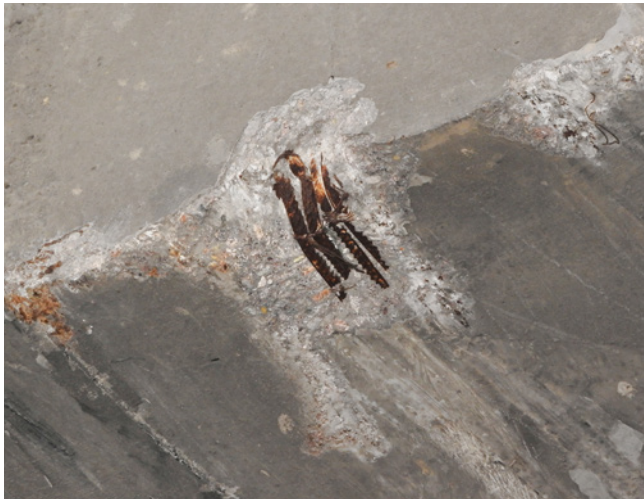
Obr. 4.1 – Železniční most přes ulici Chrudimská v Čáslavi – betonová konstrukce poškozená nárazem vozidla – na dolním povrchu NK beton „poškrábán“, na hranách je i odhalená betonářská výztuž; most v km 277,650 na TÚ 1201 Retz–Kolín
