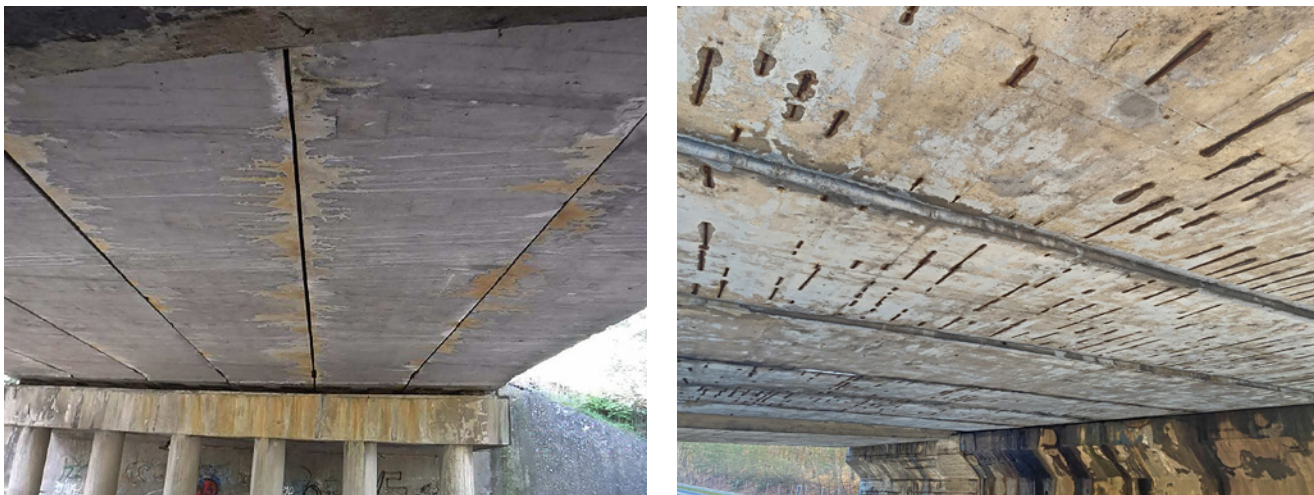
Obr. 3.81 – Typické poruchy nosníků MPD: vlevo – typické stopy zatékání podélnými spárami mezi nosíky; vpravo: povrchová koroze betonářské výztuže (nedostatečné krytí výztuže)
