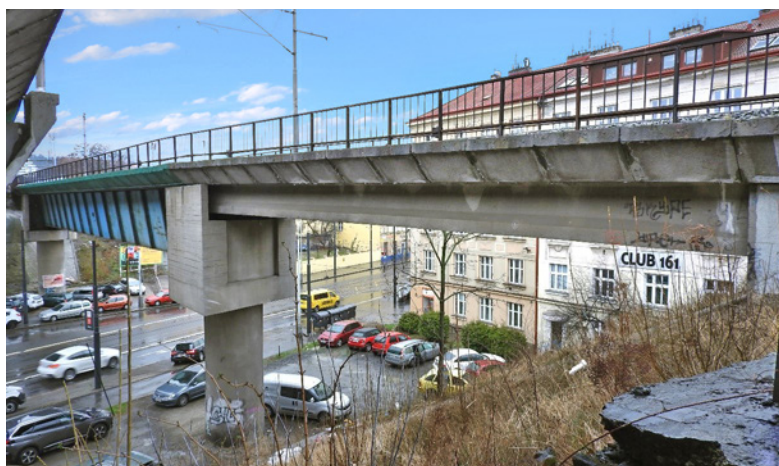
Obr. 3.65 – Železniční most přes ulici Sokolovská v Praze – pohled na krajní pole mostu z nosníků KT-21; most v km 0,230 na TÚ 0781 Balabenka–Rokytky kol. č. 501
