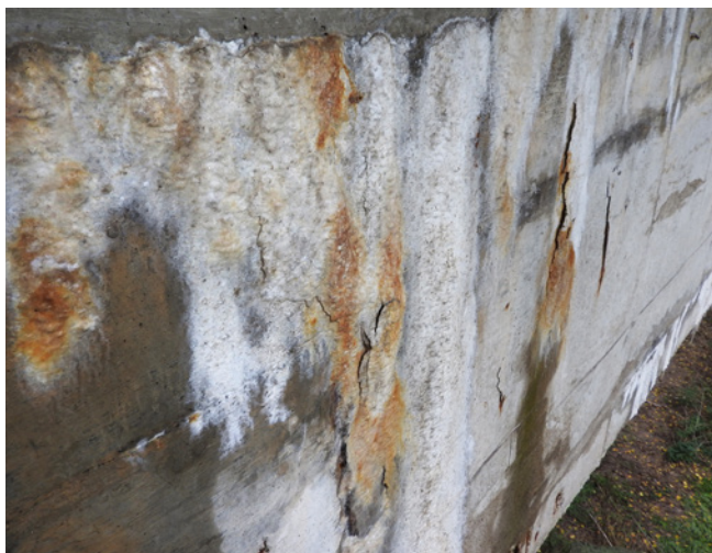
Obr. 4.7 – Železniční most u Kralup nad Vltavou (součást přemostění Vltavy) – masivní výluhy pojiva na povrchu konstrukce, odprýsknutá krycí vrstva vlivem koroze výztuže; most v km 1,508 na TÚ 0821 Kralupy nad Vltavou – Neratovice
