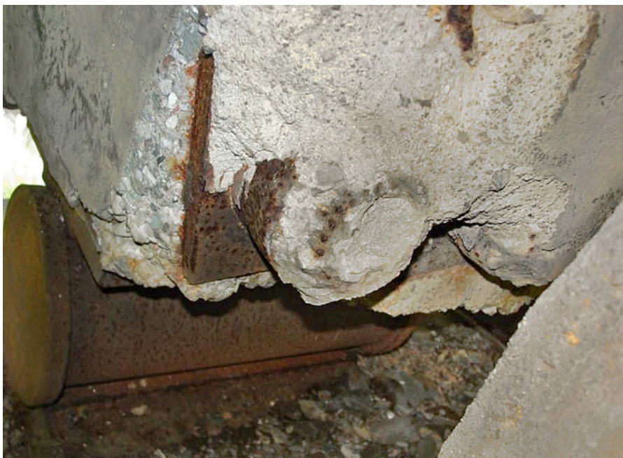
Obr. 2.15 – Železniční most u obce Myslín– kotva pro kabel z drátů (KT-24); most v km 50,453 na TÚ 0281 Protivín–Zdice
