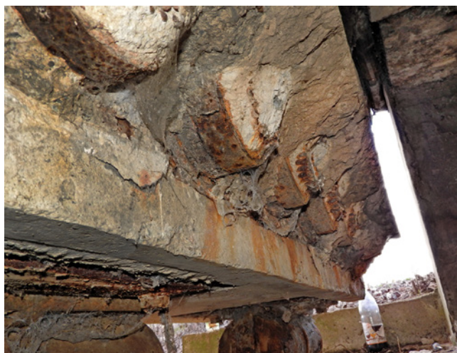
Obr. 4.34 – Železniční most u Kotojed – kotvy v místě poškozené koncové monolitické dobetonávky; most v km 3,214 na TÚ 2122 Kroměříž–Zborovice
