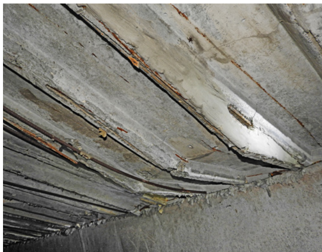
Obr. 4.6 – Železniční estakáda u rybníka Vrskaň u Jirkova – prolomení ztraceného bednění horní desky komorového průřezu (nosníky PSKT); most v km 57,225 na TÚ 0602 Most–Chomutov
