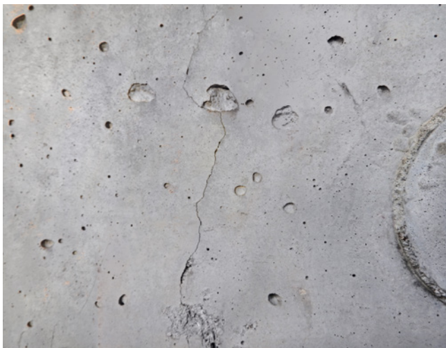
Obr. 4.19 – Železniční estakáda u Chabařovic – ohybová trhliny š. cca 0,3 mm na boční straně ŽB nosné konstrukce. U železobetonové konstrukce se přibližně jedná o limitní hodnotu (v závislosti na agresivitě okolního prostředí), v případě předpjaté konstrukce by se již jednalo o poruchu; most v km 8,035 na TÚ 0591 Ústí nad Labem – Most
