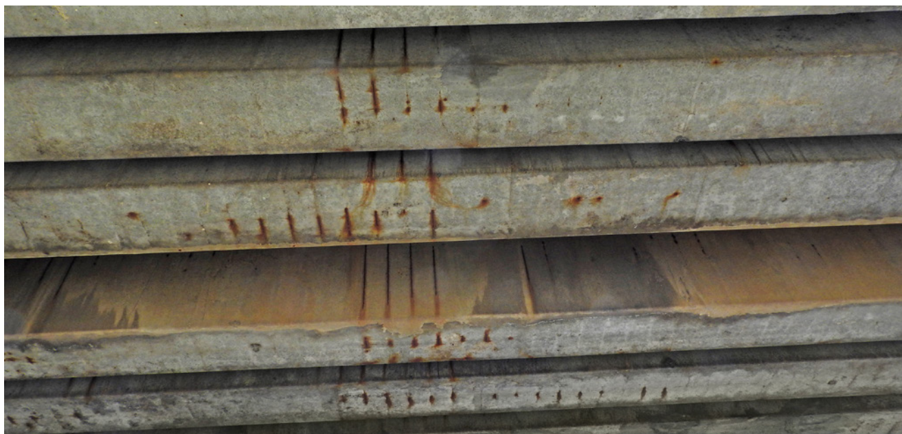
Obr. 4.29 – Železniční most u Otvic – zkorodovaná betonářská výztuž „prokreslená“ na povrchu konstrukce; most v km 59,483 na TÚ 0602 Most–Chomutov
