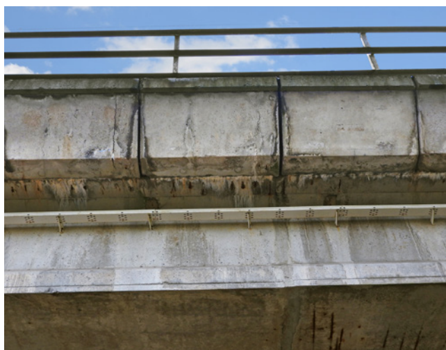
Obr. 4.39 – Železniční estakáda u Chabařovic – poškození systému vodotěsné izolace, degradace betonu a koroze výztuže prefabrikované konzoly i nosné konstrukce; most v km 10,037 na TÚ 0591 Ústí nad Labem – Most
