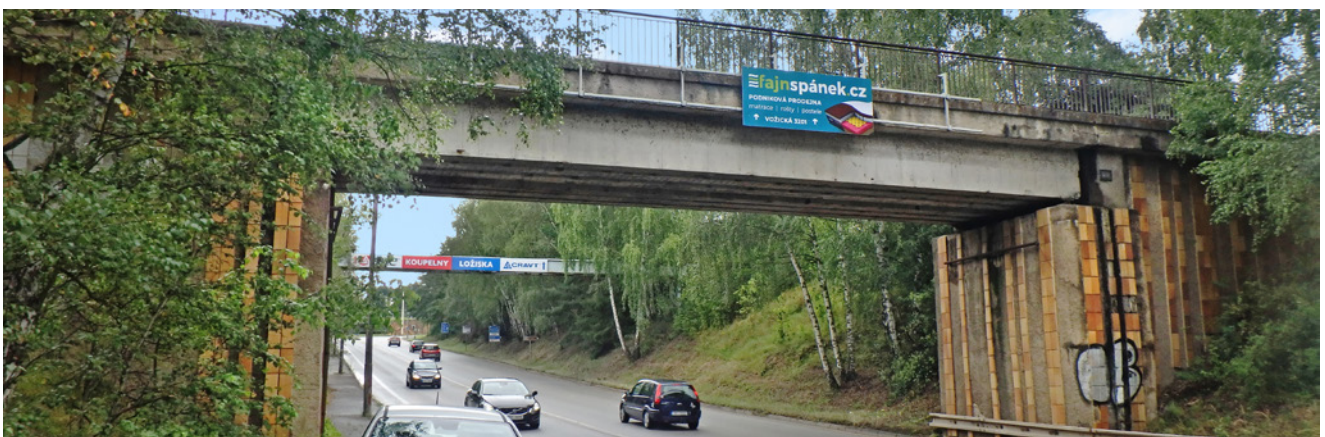
Obr. 3.84 – Železniční most přes ulici Chýnovská v Táboře – pohled; most v km 67,750 na TÚ 1851 Horní Cerekev – Tábor
