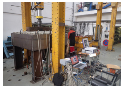
Rekonstrukce mostu v km 143,143 v žst. Brno hl. n. (Hybešova) – experimentální, numerické a diagnostické činnosti při posouzení historické a nové puklovky 1,3
