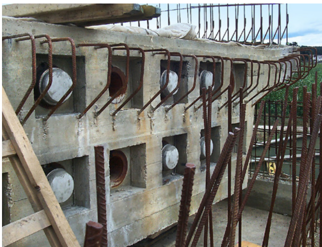
Obr. 4.35 – Železniční most v Březnu u Chomutova – kotvy předpínacích kabelů (se soudržností) v čele nosné konstrukce. Po napnutí a zainjektování kabelů byly kotvy zabetonovány. Zejména u kabelů bez soudržnosti („volných kabelů“) bývá ponechána víčka kotev přístupná pro zachování možnosti snadné výměny kabelů; most v km 0,425 na TÚ 0101 Praha–Chomutov
