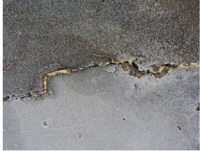
Obr. 4.27 – Železniční most ve Veselí nad Lužnicí – příčná spára mezi jednotlivými díly prefabrikovaných nosníků nedokonalě vyplněná epoxidem; most v km 35,605 na TÚ 1781 Nemanice – Veselí nad Lužnicí
