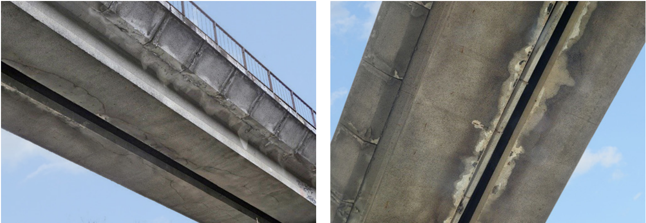
Obr. 3.66 – Typické poruchy nosníků KT: výrazné stopy po zatékání skrz podélnou spáru mezi prefabrikovanými nosníky a zatékání spárami prefabrikovaných říms, vápenné výluhy, lokálně koroze měkké výztuže a odpadávání krycí vrstvy betonu
