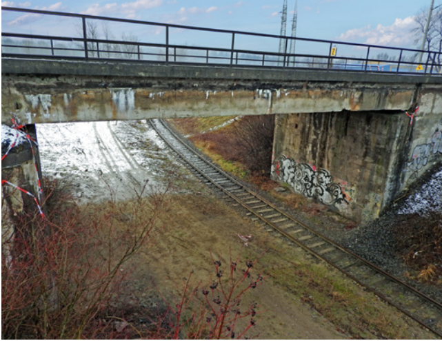
Obr. 4.26 – Železniční most přes řeku Ostravici v Ostravě – trhlinka mezi povrchem nosné konstrukce a navazující římsovou zídkou; most v km 32,544 na TÚ 2561 Polanka nad Odrou – Ostrava-Kunčice
