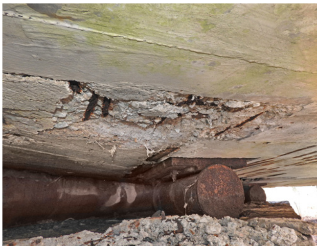
Obr. 4.9 – Železniční most u Moravského Berouna – degradace betonu – zatékání, mrazové cykly a expanzní tlaky koroďující výztuže; most v km 36,651 na TÚ 2191 Olomouc–Krnov; opraveno
