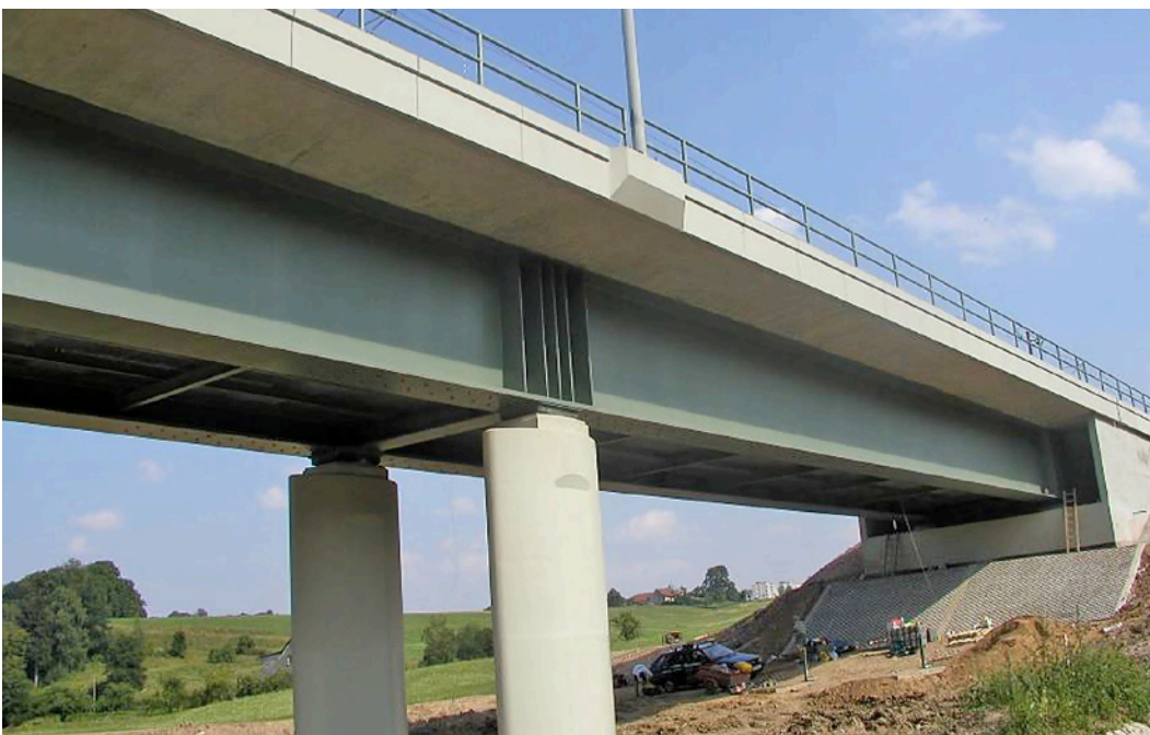
Obr. 2.45 – Monolitické železobetonové římsy s lícovými prefabrikáty a s rozšířenými bloky pro kotvení stožárů trakčního vedení
