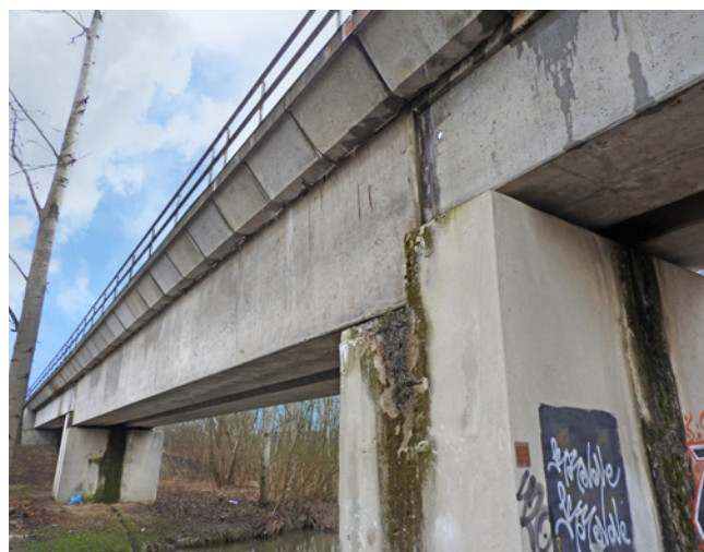
Obr. 4.13 – Železniční most přes řeku Ploučnici u Zákup – zatékání příčnou dilatační spárou nosné konstrukce nad podpěrou; most v km 90,270 na TÚ 1141 Česká Lípa – Liberec
