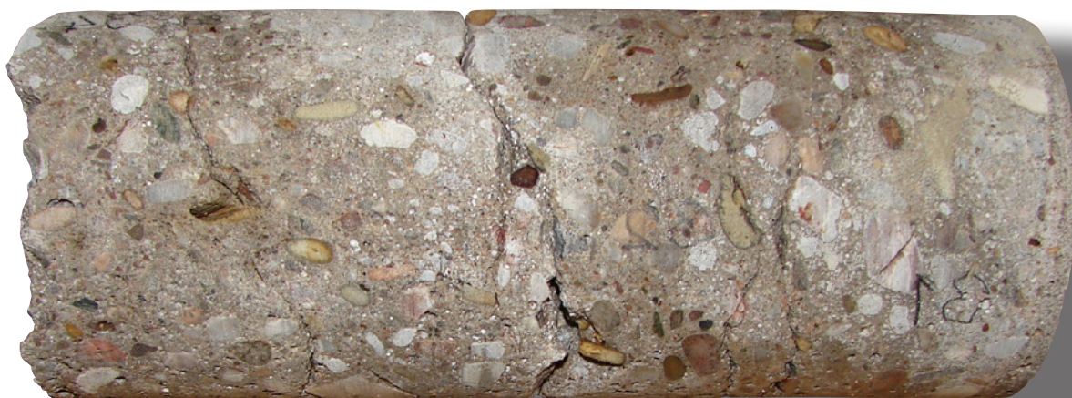
Obr. 4.11 – Beton napadený ASR, Ø 100 mm (foto doc. Ing. Petr Bouška, CSc.)
