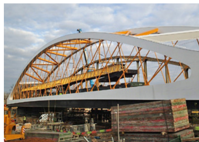
Rekonstrukce mostu v km 80,930 trati Hohenau (ÖBB) – Přerov – „Oskar“ 1,3,4 Investor: SŽDC, s.o. Objednavatel: FIRESTA
