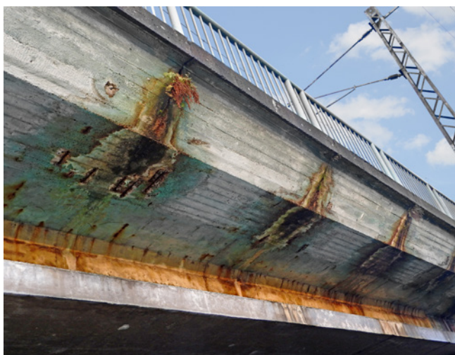
Obr. 4.38 – Železniční most přes silnici III. třídy a potok Bys-třice v obci Kozlíky – poškození systému vodotěsné izolace, degradace betonu a koroze výztuže monolitické římsy i nosné konstrukce; most v km 12,805 na TÚ 0661 Ústí nad Labem – Bílina
