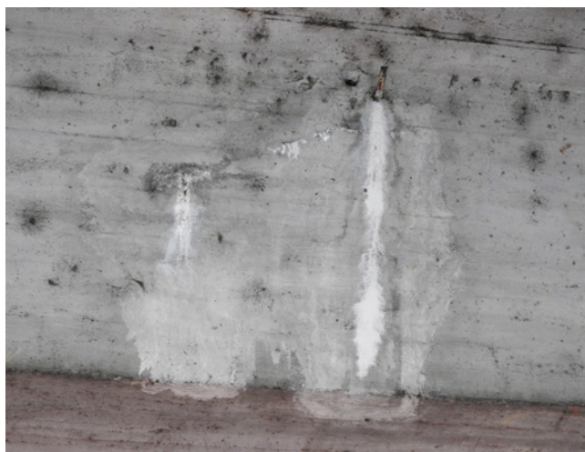
Obr. 4.17 – Železniční most přes ulici Dorných v Brně – zatékání vody do vnitřního objemu konstrukčního betonu (výchvěty, degradace betonu, korozí výztuže); most v km 2,838 na TÚ 2005 Brno–Heršpice
