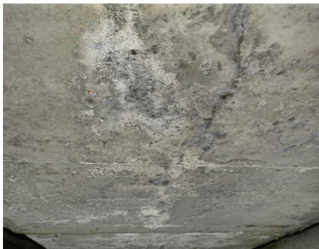
Obr. 4.10 – Železniční most přes řeku Vrchlice v Kutné Hoře – degradace betonu – projev mrazových cyklů na dolním povrchu konstrukce nad vodotečí; most v km 287,291 na TÚ 1201 Retz–Kolín
