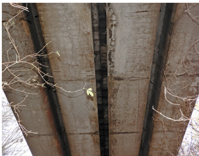
Obr. 4.12 – Železniční estakáda u Chabařovic – zatékání podélnou spárou mezi prefabrikovanými nosníky; most v km 10,037 na TÚ 0591 Ústí nad Labem – Most
