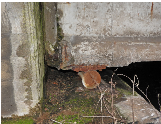
Obr. 4.14 – Železniční most přes řeku Vrchlice v Kutné Hoře – zatékání příčnou dilatační spárou na úložný práh k ložiskům (voda na úložném prahu, degradace betonu, korozí výztuže, degradace ložisek); most v km 287,291 na TÚ 1201 Retz–Kolín
