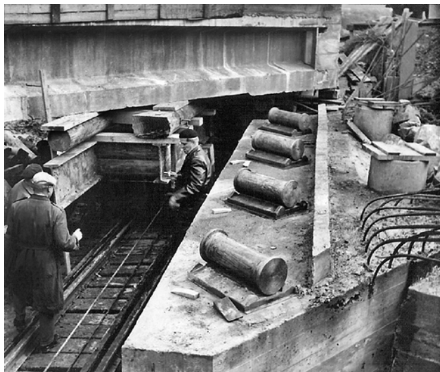
Obr. 3.10 – Železniční most v Bdeněvesi – příčný výsuv mostu; most v km 362,050 na TÚ 0203 Plzeň–Cheb (v současné době je konstrukce nahrazena)
