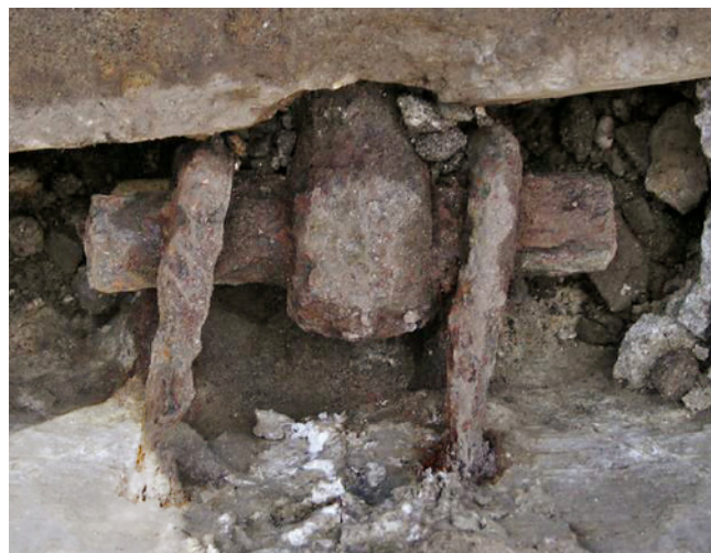
Obr. 4.43 – Korozí oslabené kotvení konzoly KO-1
