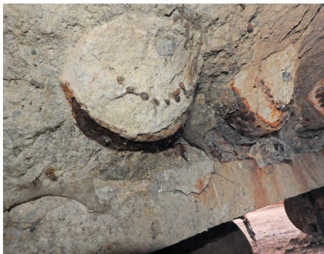
Obr. 4.8 – Železniční most u Kotojed – degradace betonu – zatékání a mrazové cykly; most v km 3,214 na TÚ 2122 Kroměříž–Zborovice
