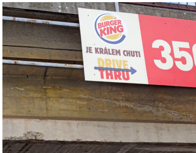
Obr. 4.23 – Železniční most přes Chodovskou ulici v Praze – trhliny podél kabelových kanálků vznikající následkem omezení volného smršťování betonu okolo kanálků – šikmá trhlina podél šikmého kabelu; most v km 3,007 na TÚ 0206 Praha-Vršovice – Praha-Radotín
