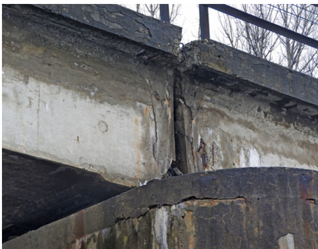
Obr. 4.24 – Železniční most přes řeku Ostravici v Ostravě – trhliny mezi předpjatou nosnou konstrukcí a koncovými monolitickými dobetonávkami pro ochranu kotvě kabelů; most v km 32,544 na TÚ 2561 Polanka nad Odrou – Ostrava-Kunčice
