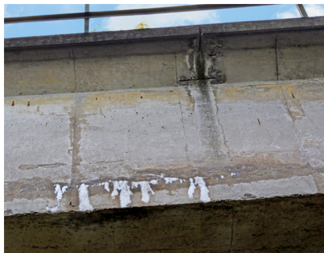
Obr. 4.25 – Železniční most u Kralup nad Vltavou (součást přemostění Vltavy) – trhlina mezi povrchem dolní desky a navazující stěnou komorového průřezu; most v km 1,508 na TÚ 0821 Kralupy nad Vltavou – Neratovice
