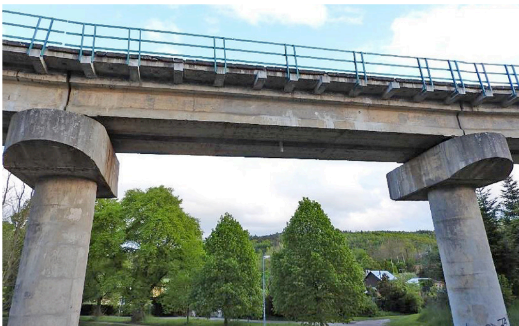
Obr. 2.43 – Tyčové konzoly podpírající kabelové žlaby
