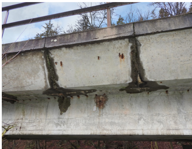
Obr. 4.15 – Železniční most u Hluboček – zatékání podélnou spárou a příčnými spárami u prefabrikovaných konzol; most v km 12,897 na TÚ 2191 Olomouc–Krnov
