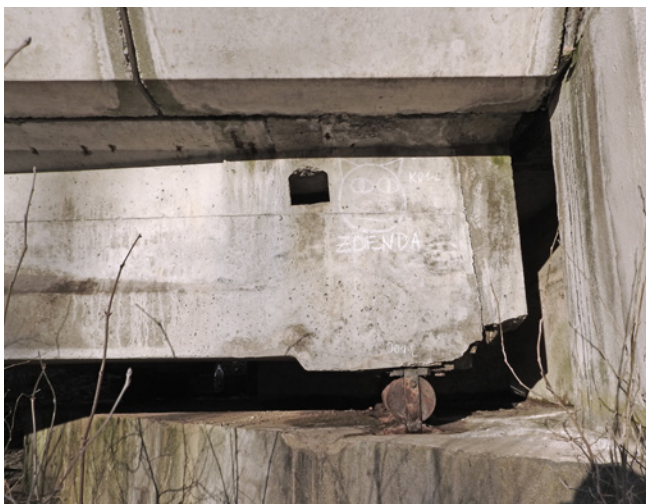
Obr. 4.40 – Železniční most u Kotojed – zatékání na úložný práh (porušeným mostním závěrem), degradace betonu, koroze výztuže, koroze a znečištění ložisek, odtržená monolitická dobetonávka; most v km 3,214 na TÚ 2122 Kroměříž–Zborovice
