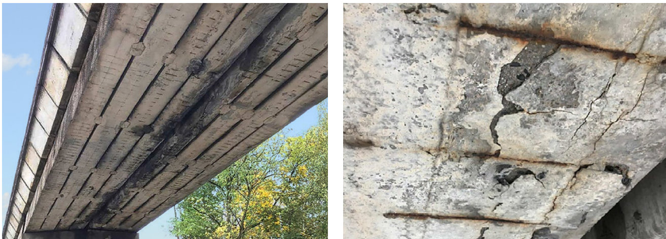
Obr. 3.85 – Typické poruchy nosníků MT – vlevo: pohled na podhled NK; vpravo: detail narušení krycích vrstev nosníku při středové spáře
