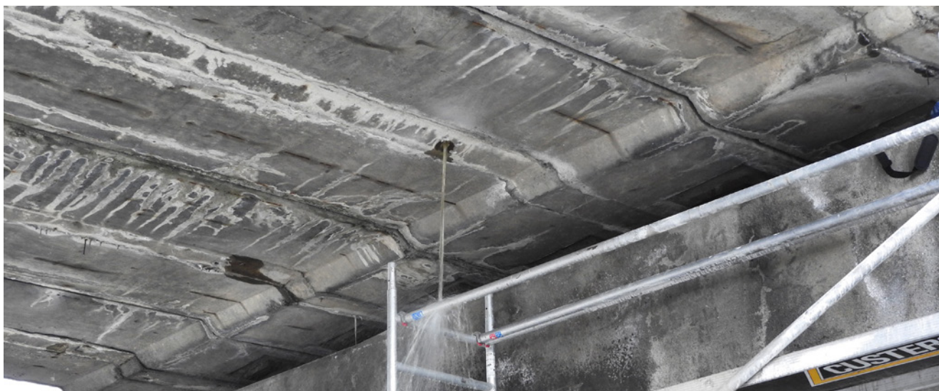
Obr. 4.18 – Železniční most přes Chodovskou ulici v Praze – zatékání vody do dutiny konstrukce s uzavřeným průřezem (vytékání vody z dutiny po provedení vrtu do dolní desky); most v km 3,007 na TÚ 02060 Praha-Vršovice – Praha-Radotín
