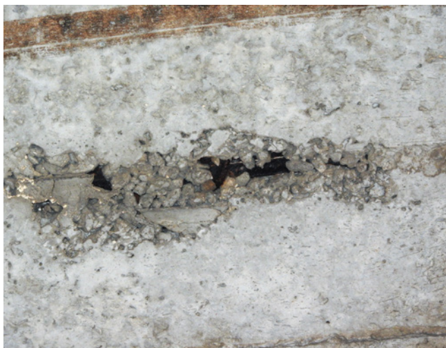
Obr. 4.5 – Železniční most u Lýsek – Nekvalitní probetonování nosné konstrukce; most v km 5,429 na TÚ 1908 Prosenice–Dluhonice
