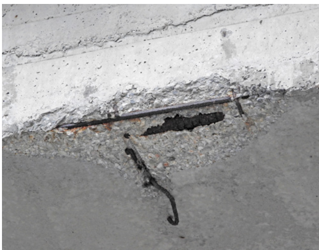
Obr. 4.3 – Železniční most přes silnici I/19 v Leskovicích – mechanické poškození betonové konstrukce s odhaleným kanálikem předpínací výztuže a s porušenou betonářskou výztuží; most v km 31,877 na TÚ 1851 Horní Cerekev – Tábor
