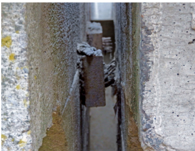
Obr. 4.33 – Železniční most u Pustovět – odhalená a korodující kotva s předpínací výztuží; most v km 34,516 na TÚ 0761 Beroun–Rakovník
