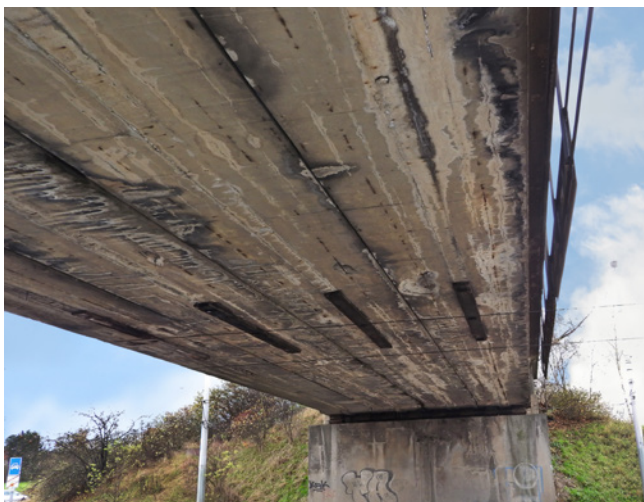
Obr. 4.22 – Železniční most přes Chodovskou ulici v Praze – trhliny podél kabelových kanálků vznikající následkem omezení volného smršťování betonu okolo kanálků; most v km 3,007 na TÚ 0206 Praha-Vršovice – Praha-Radotín
