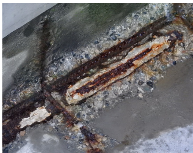
Obr. 4.32 – Železniční most přes silnici I/19 v Leskovicích – koroze obnažené betonářské výztuže a předpínací výztuže (kabel z patentovaných drátů) v otevřeném kabelovém kanálku; most v km 31,877 na TÚ 1851 Horní Cerekev – Tábor
