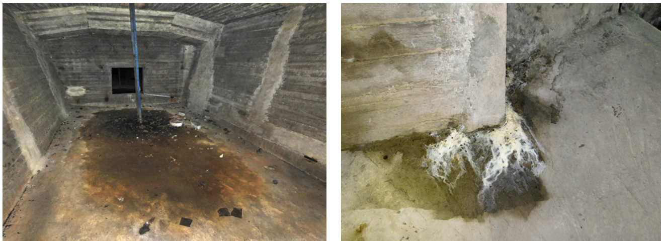
Obr. 3.118 – Vlevo: zatékání do komory vstupním otvorem z kolejiště v poli 1; vpravo: lokální průsak s výluhy v poli 1
