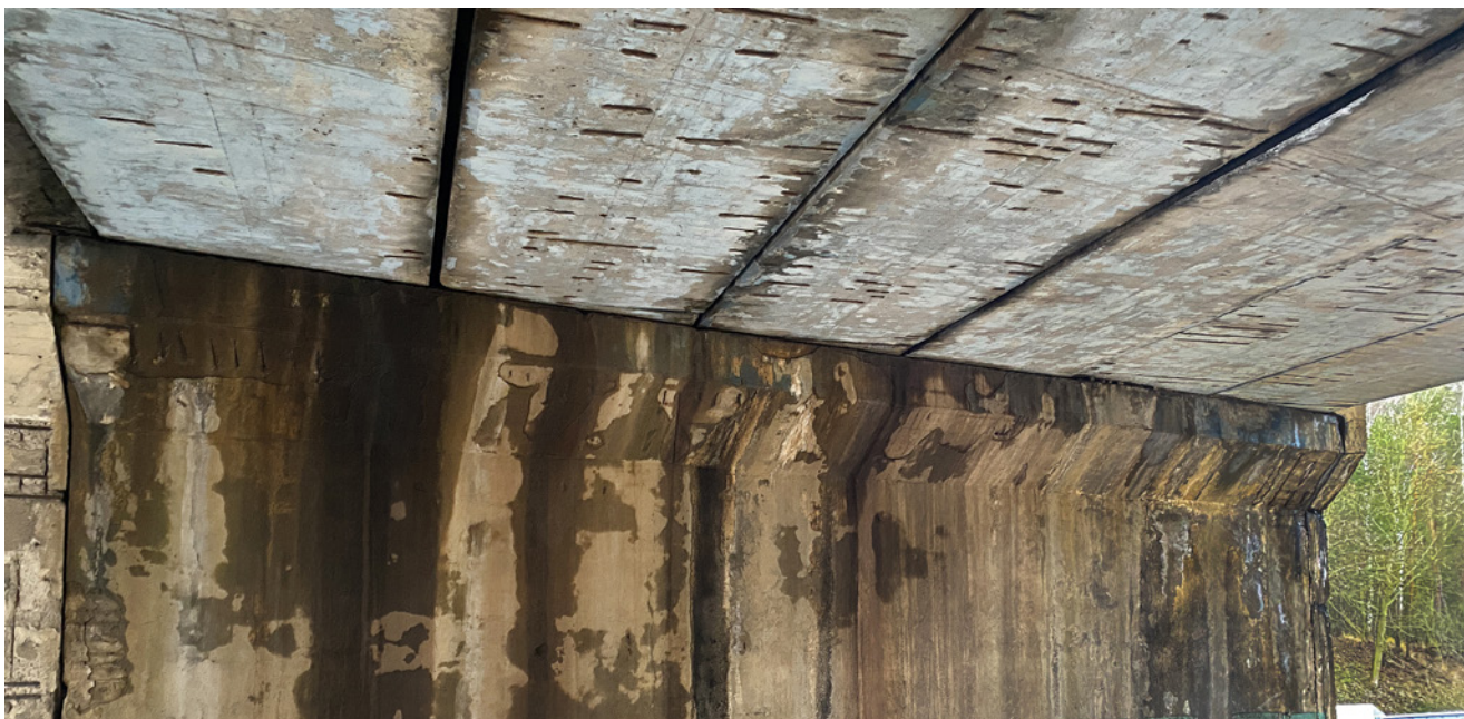
Obr. 3.80 – Železniční most přes dálnici D10 ve Staré Boleslavi – pohled; most v km 348,054 na TÚ 0921 Lysá nad Labem – Všetaty
