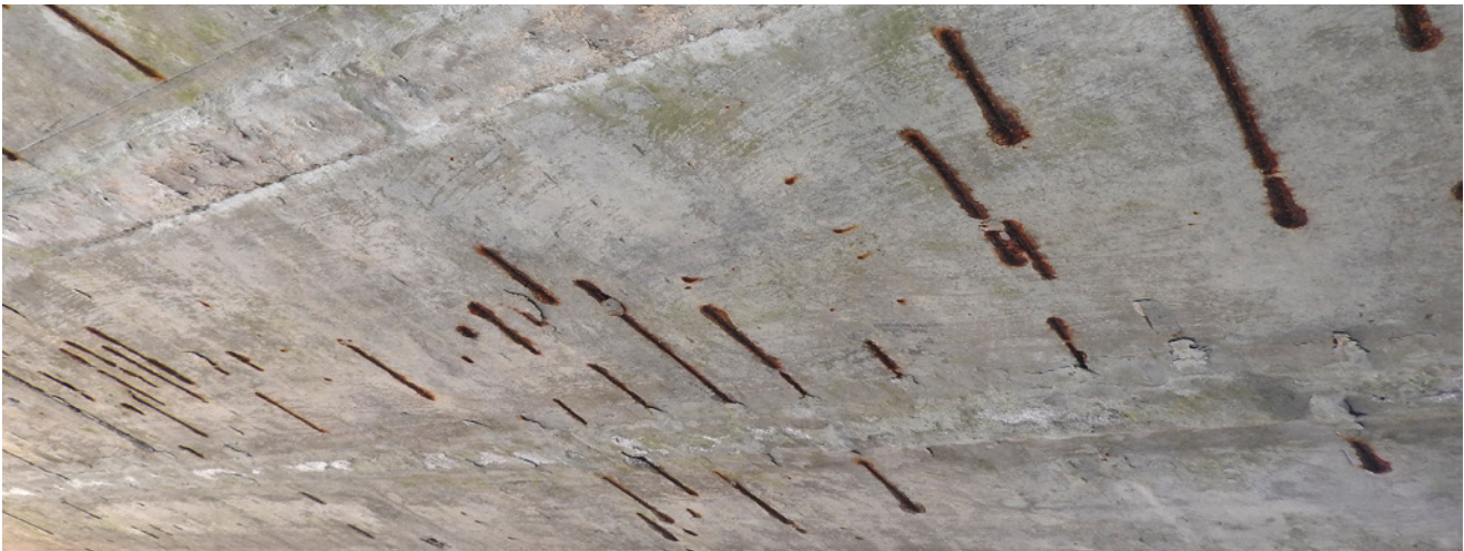
Obr. 4.28 – Železniční most u Moravského Berouna – trhlinky vzniklé v důsledku koroze výztuže a zvětšování objemu korozních produktů; most v km 36,651 na TÚ 2191 Olomouc–Krnov (opraveno)
