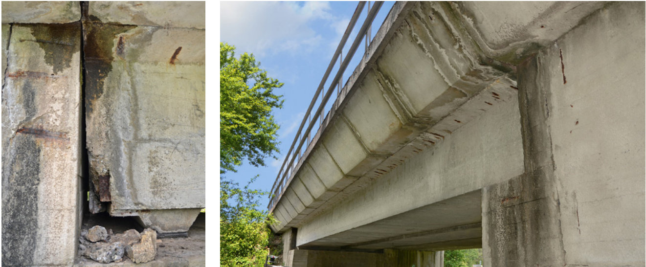
Obr. 3.71 – Typické poruchy nosníků KDP: silně zvodnělá a odlomená dobetonávka čela nosníku, obnažené korodující výztužné vložky v pohledu horní příruby nosníku
