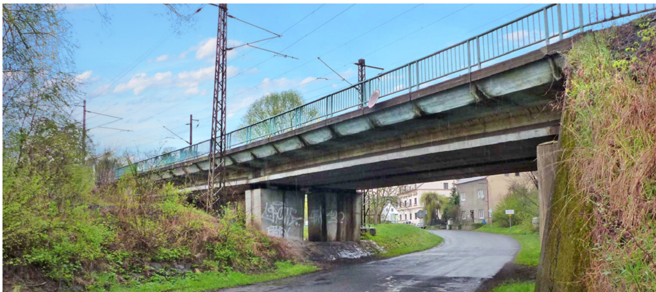
Obr. 3.88 – Železniční most přes silnici III. třídy a potok Bystřice v obci Kozlíky – pohled; most v km 12,805 na TÚ 0661 Ústí nad Labem-Trmice - Bílina
