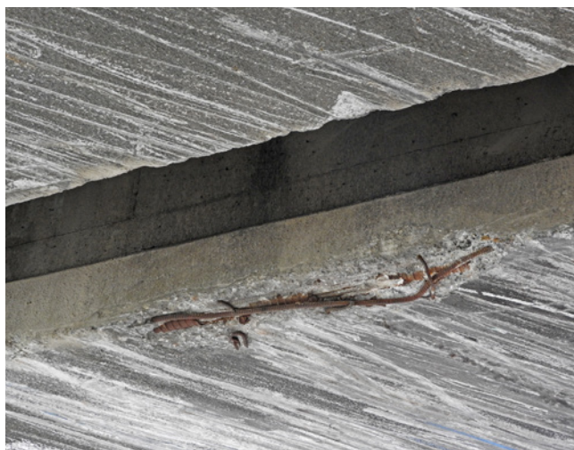
Obr. 4.4 – Železniční estakáda Rokytky v Praze – mechanické poškození betonové konstrukce s odhalenou betonářskou i předpínací výztuží; most v km 1,225 na TÚ 0791 Praha-Libeň – Praha-Holešovice
