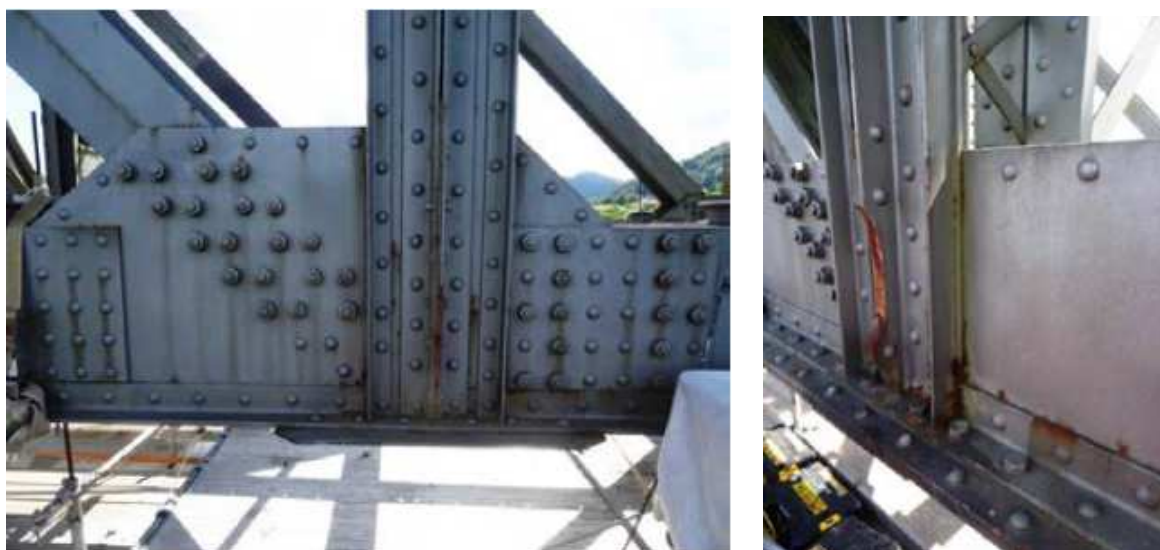
Obr. 24: Pohled na konstrukci před otryskáním – PKO na površích je stále funkční, dochází k lokální korozi, korozní úbytky jsou stále zanedbatelné
