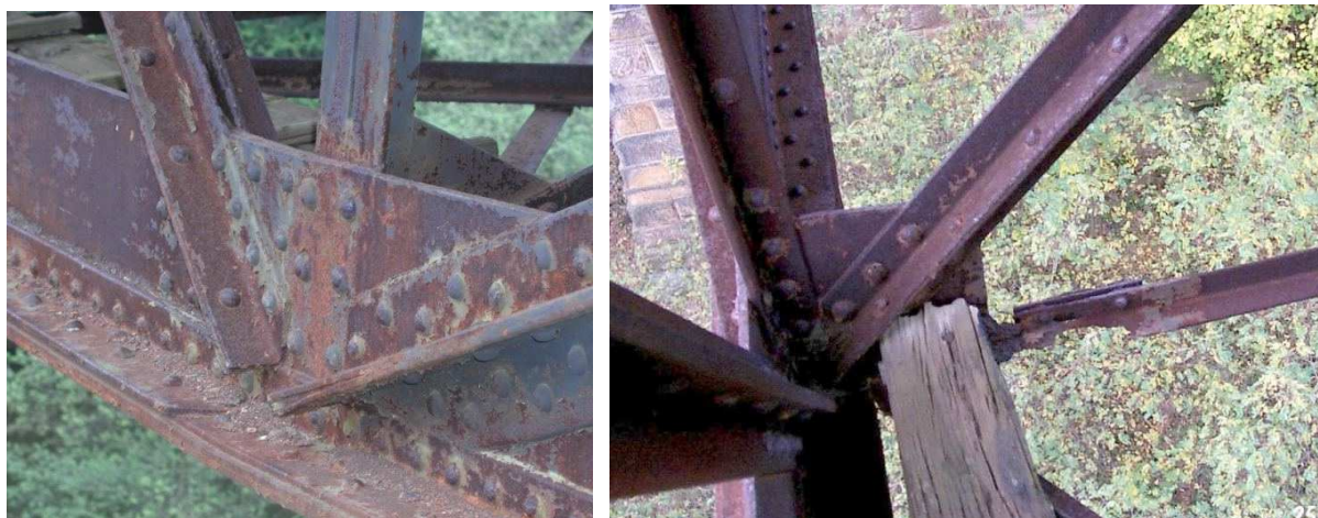
Obr. 8: Detaily mostní konstrukce před opravou
