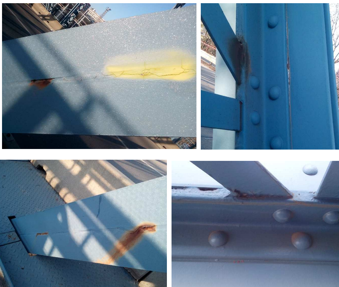
Obr. 5: Závady 13 let po rekonstrukci (foto z roku 2018) [foto SUDOP]
