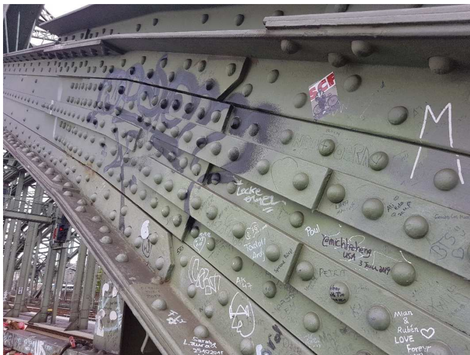
Obr. 20: Detail oblasti oblouku s velkou koncentrací nýtových spojů a příložek
